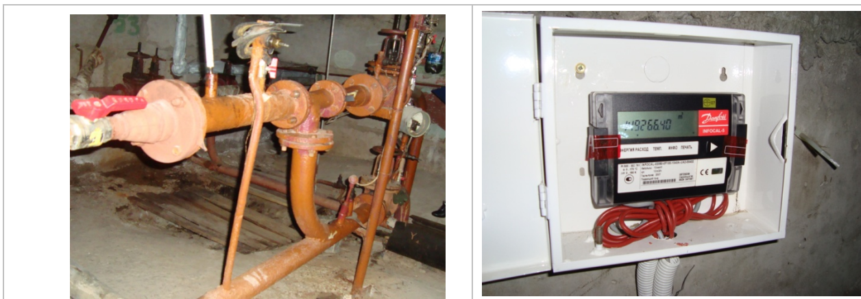
Рисунок 5.1.1. Вузол теплового ведення та тепловий лічильник
